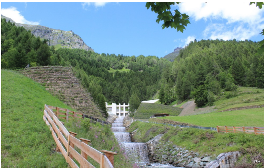
Abbildung 5: Technische Maßnahmen zum Schutz vor Muren oberhalb von Prägraten. Photo: Peter Hajek.
